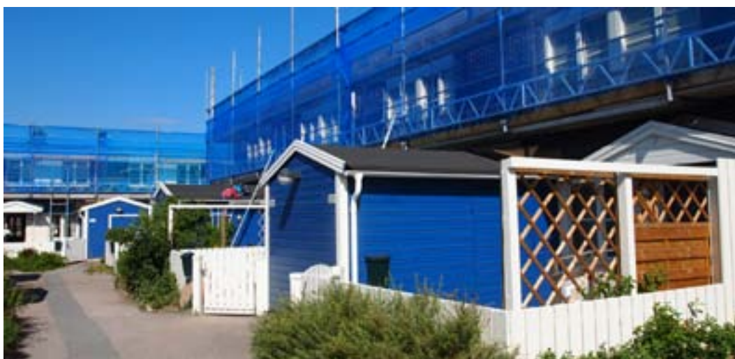
På Hasselgatan pågår ett miljöprojekt där vi bland annat byter ut alla fönster samt att vi utifrån en workshop tillsammans med de boende genomför en större upprustning av utemiljön.
